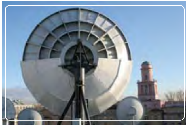
Антенные посты станций спутниковой связи сети RUNNet на крыше Университета ИТМО
